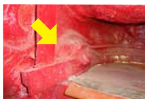
牙内側取付け部、ひび割れ。
